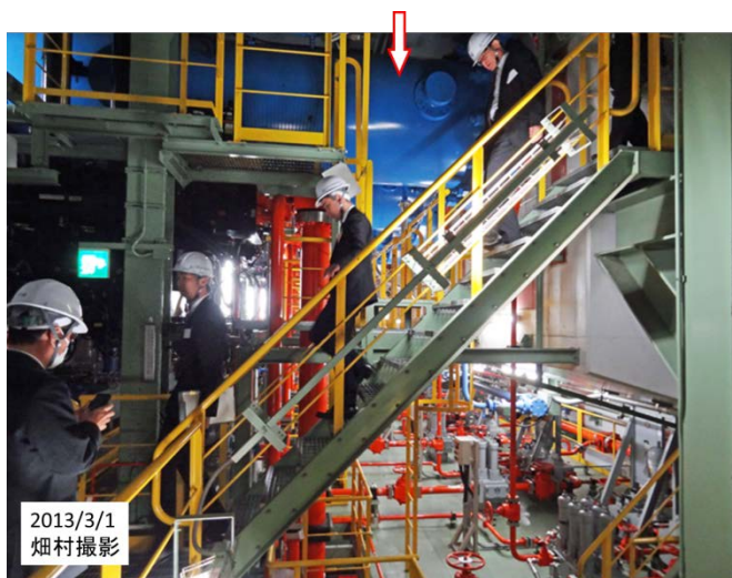
図3 水平方向の油圧シリンダ(上方の青い筒) (内径1.5m, 外径1.8m(?))
