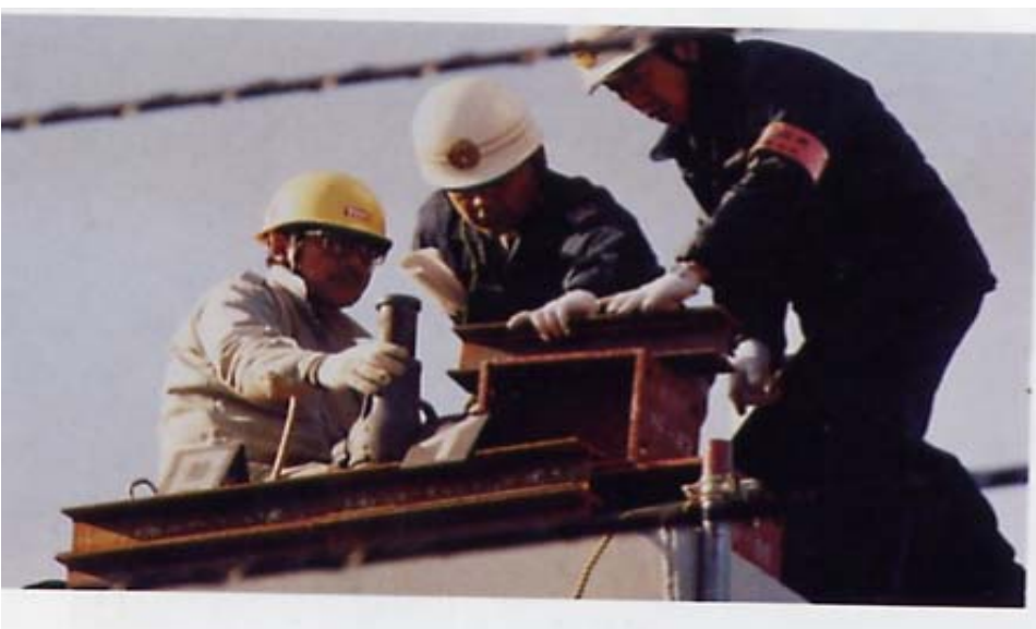
写真 3 : 補強リブの入っていない H 型鋼 ( 出典 : 日経コンストラクション編 : 建設事故 p 1 6 )
