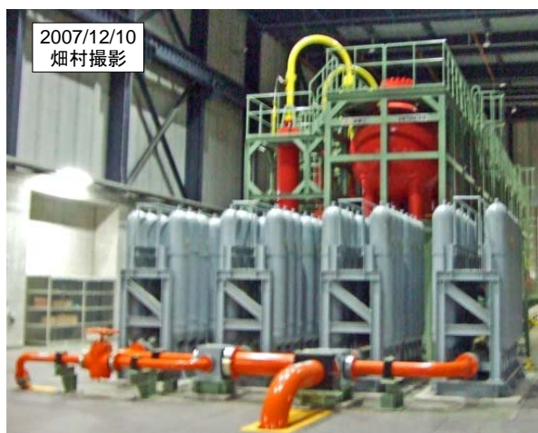
写真3 制御用油圧システムに用いられているアキュムレータ(蓄圧器) (N 2 ガスポンプ(灰色)と油タンク(橙色))
