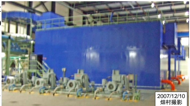
写真2 動力源のLNG使用のガスエンジン(青いカバーの中にある) (これで直接に斜板形レシプロポンプを駆動している)
